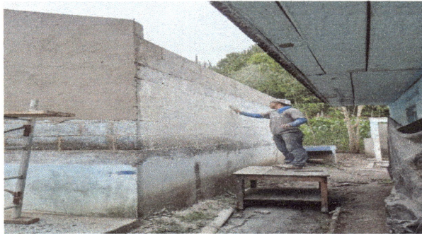
Foto 5: Cernido de paredes exteriores de cocina.
